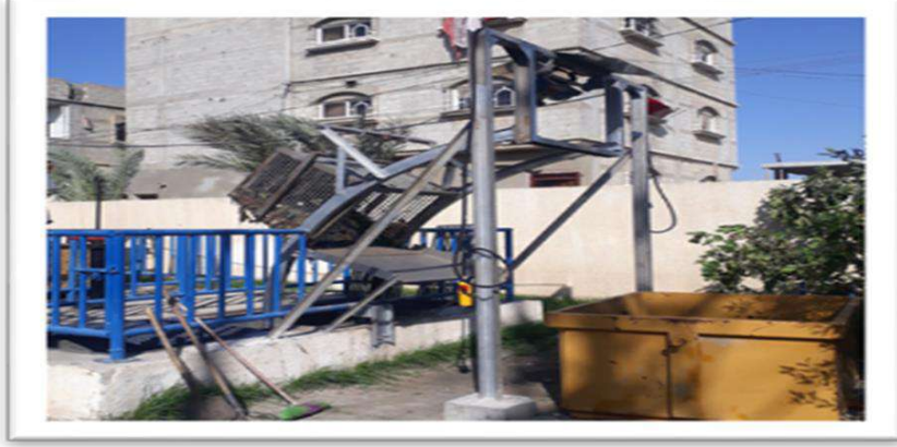
محطة ضخ صرف صحي
